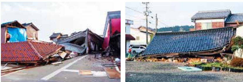
穴水町中心部の建物崩壊状況、街中至る所で崩壊している
